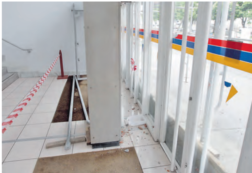
La entrada trasera ha sido precintada por las obras de urgencia que se acometen en el exterior. J. PARDO
